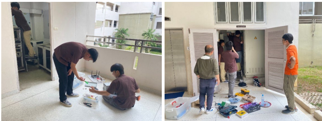
รูปที่ 6 การติดตั้งอุปกรณ์เพื่อเก็บค่าการใช้ไฟฟ้าของอาคาร C2
